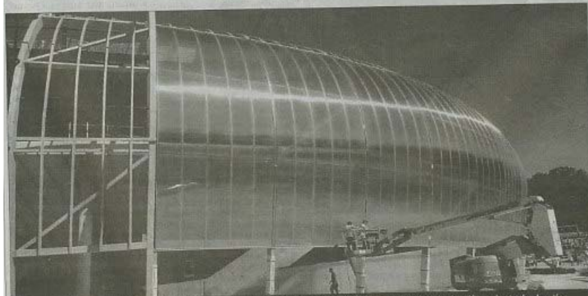
CHANTIER. A l'extérieur, la pose de l'habillage se poursuit et sera bientôt achevée. Sauf problème de dernière minute, le chantier sera réceptionné comme prévu, fin décembre.
